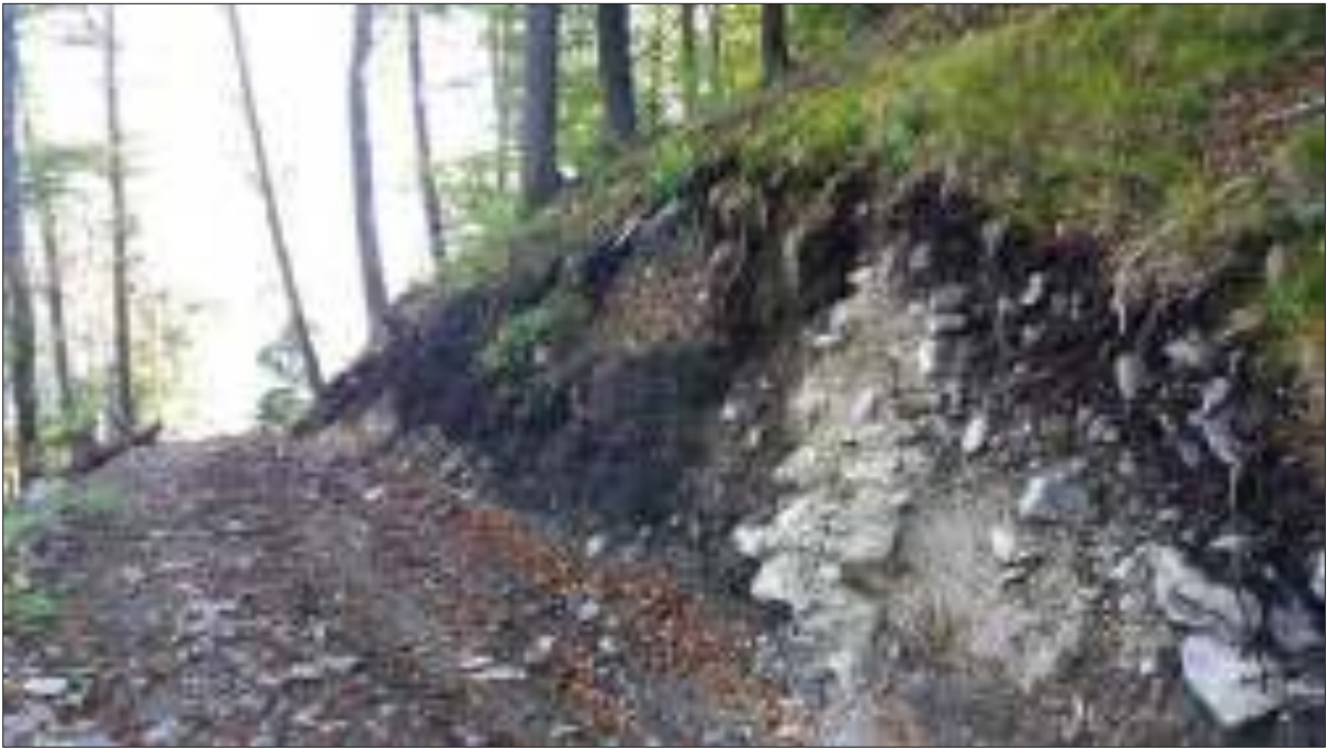
Sl. 1.21: Kašča. Presek čez severno pobočje (T6), izpostavljen z gradnjo vlake, ob identifikaciji uničenja arheološkega najdišča 1. 10. 2017. Pogled proti vzhodu (foto: A. Gaspari; 124501).
